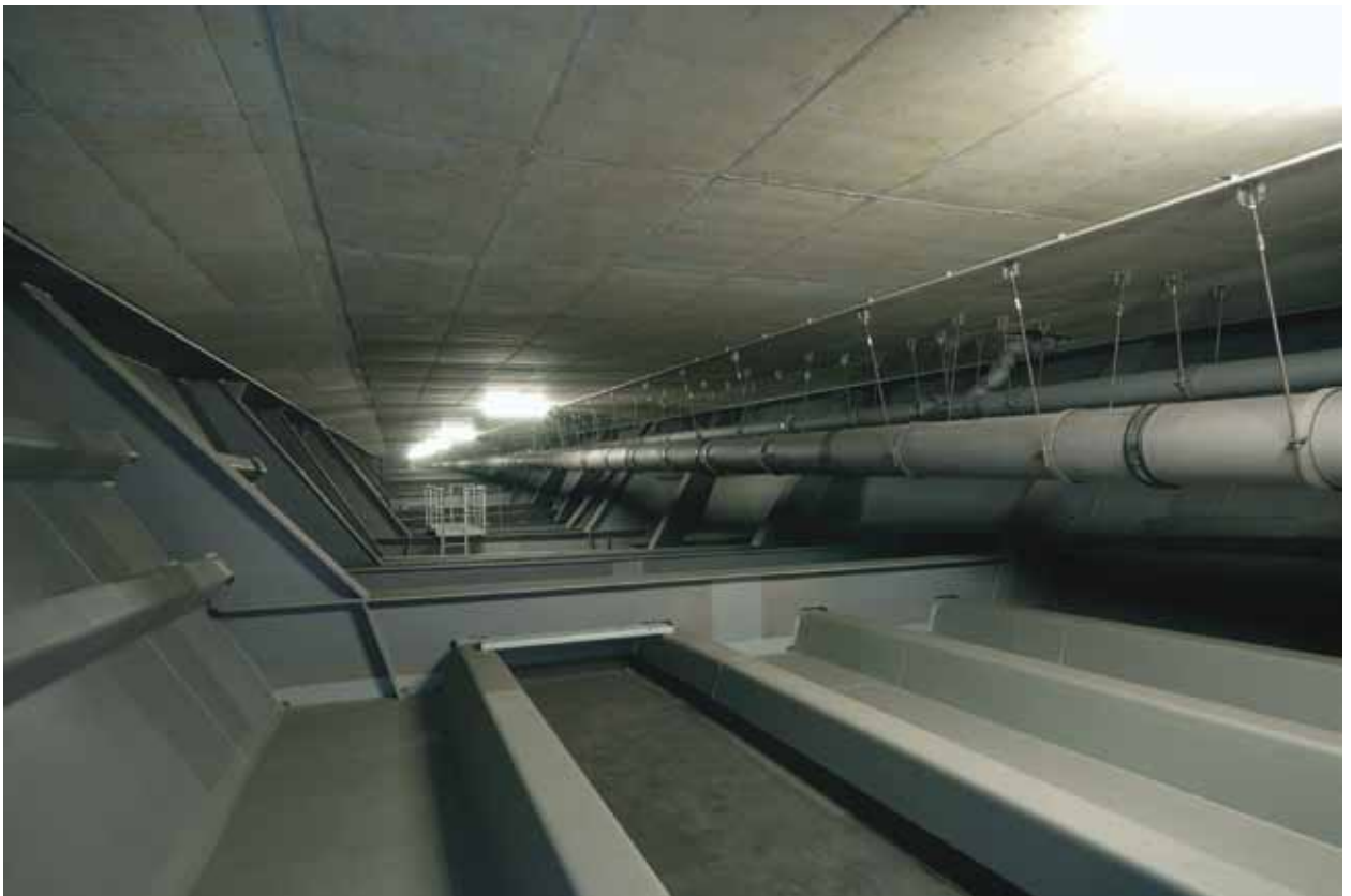
Bild 29: Ausstattung eines Hohlkastens mit Beleuchtung
