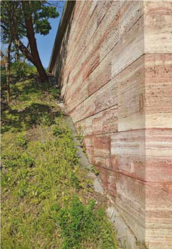
Bild 21: Böschung ohne Böschungstreppe (schlechte konstruktive Lösung)
