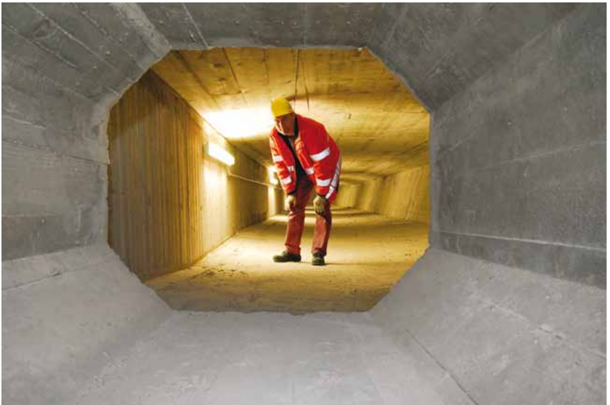
Bild 26: Erschwerte Begehbarkeit eines Hohlkastenüberbaus infolge zu geringer lichter Durchgangshöhe
