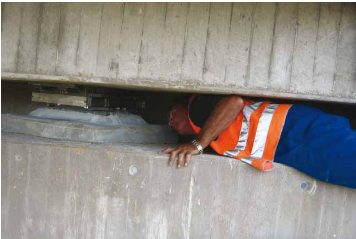
Bild 27: Erschwerte Lagerprüfung bei zu geringem Abstand zwischen Auflagerbank und Überbau
